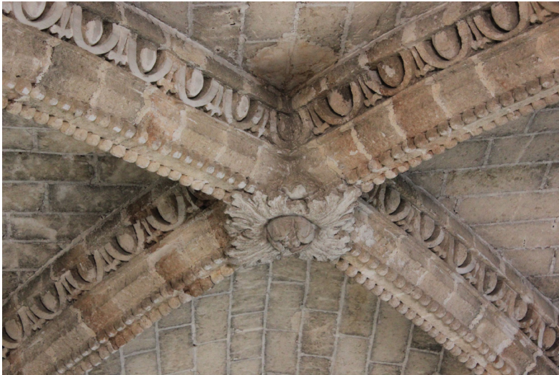
Fig. 1. Costoloni della campata quadrangolare, voltata a crociera, nel presbitero turrito della Collegiata di Manduria (TA) dedicata alla Santissima Trinità. Dettaglio del concio di chiave e dell'innesto dei conci rispetto il fondo del sistema voltato (secolo XIII?; foto 2020, Ilaria Pecoraro).
