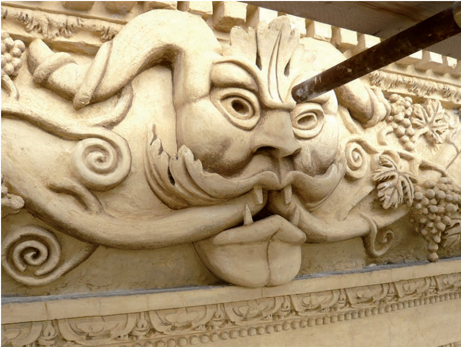
Fig. 17. Villa Grimaldi Sauli in Bisagno, particolare del fregio "della vigna" scattato dai ponteggi durante i restauri.
